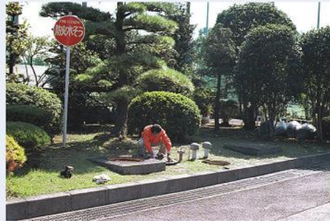
2. 100トンの耐震性地下貯水槽
